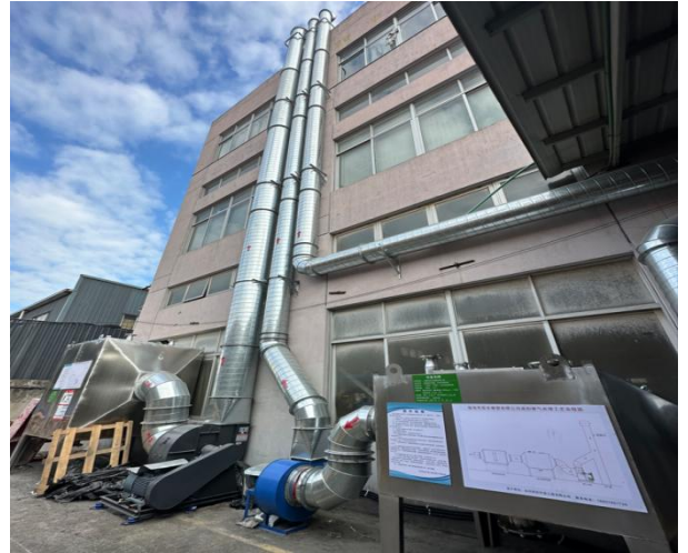
PVC 挤出、涂塑废气排气筒
