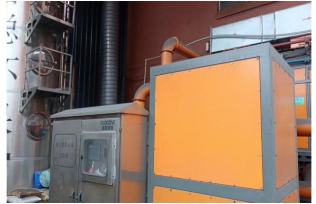
废气处理设施
