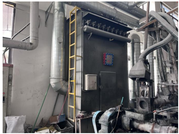
废气处理设施
