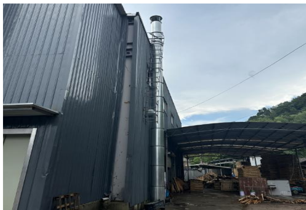
硫化废气排气筒
