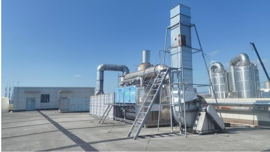
油漆废气处理设施
