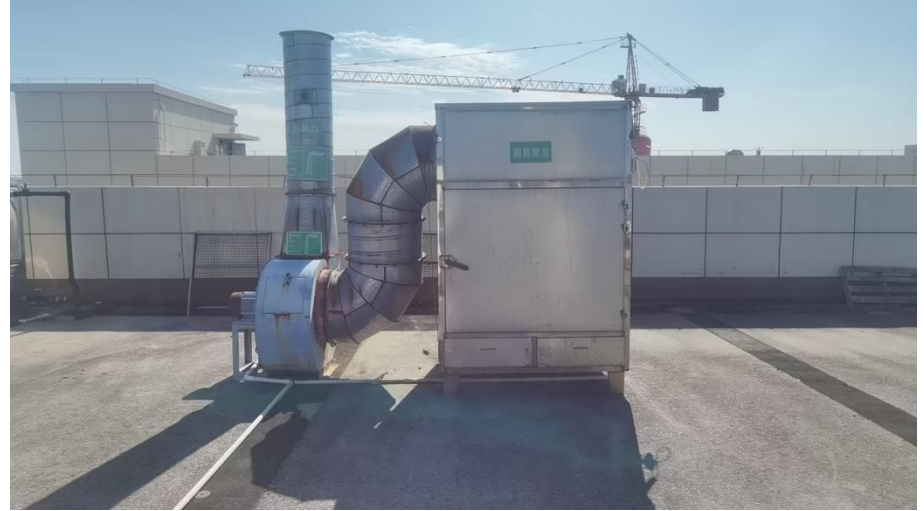
磨水口拉砂废气处理设施
