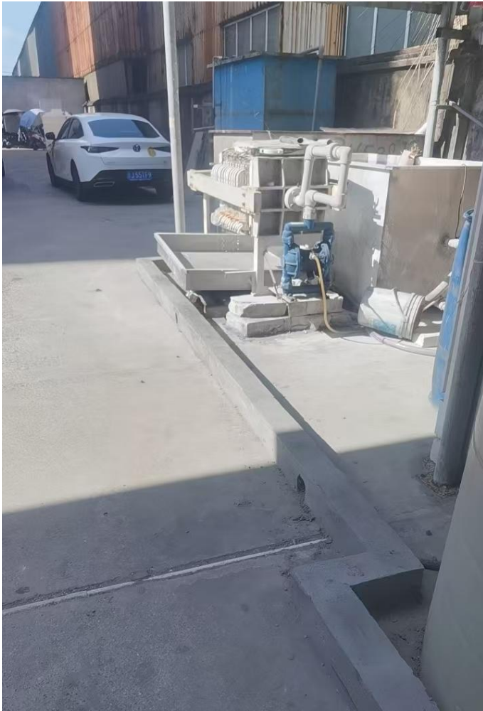
振机废水处理设施
